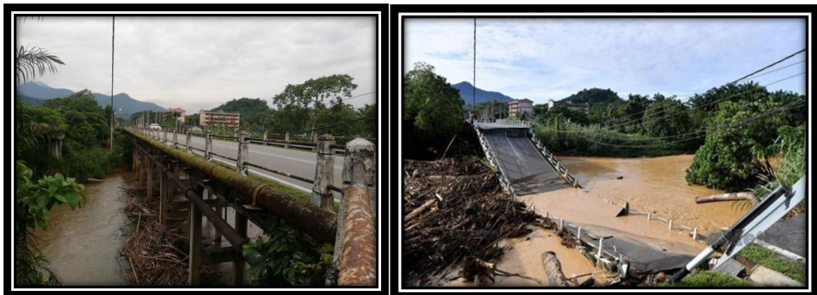
Rajah 1 dan 2: Jambatan Slim River yang menjadi saksi kepada Pertempuran Slim River 1942. Gambar di sebelah kiri menunjukkan keadaan jambatan pada tahun 2017 dan gambar di sebelah kanan menunjukkan jambatan tersebut runtuh pada 23 Ogos 2024 lalu.
